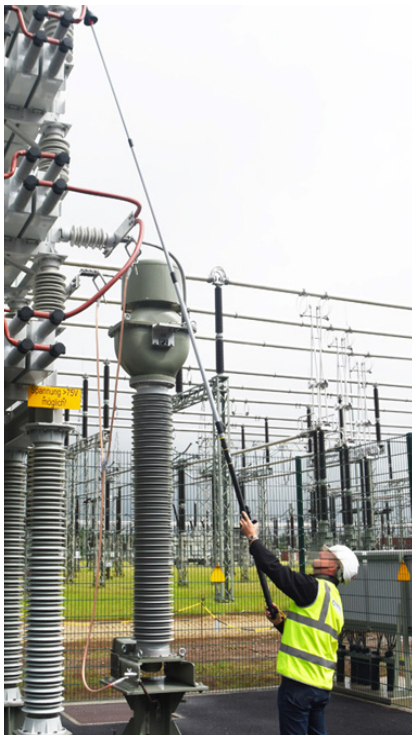
Měření na 36 kV zařízení
