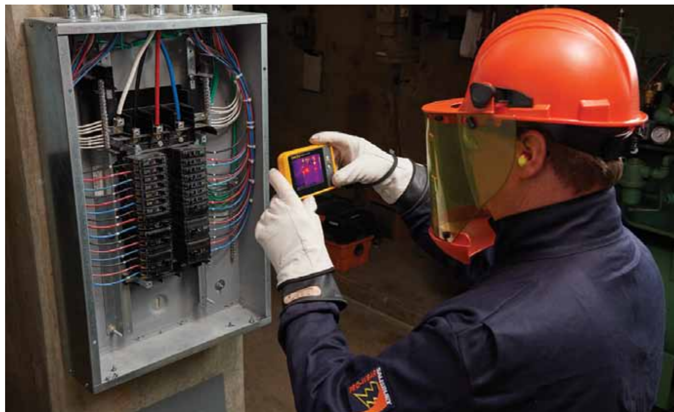
Obrázek 2: Kontrola rozvaděče s kapesní termokamerou Fluke PTi120
