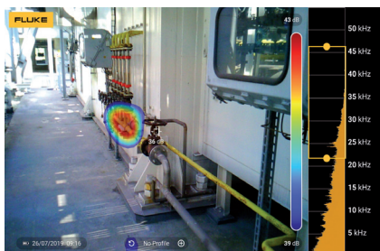
Pohľad na plynové potrubie z diaľky – orientačné určenie miesta úniku plynu
